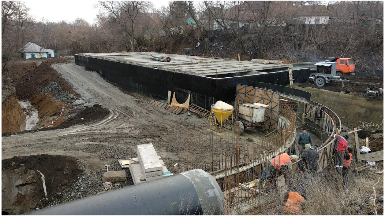
На фото процес будівництва системи збору та очищення зливових стоків по Кленовій балці, 2021. Джерело: Максим Бородін, особистий архів.
