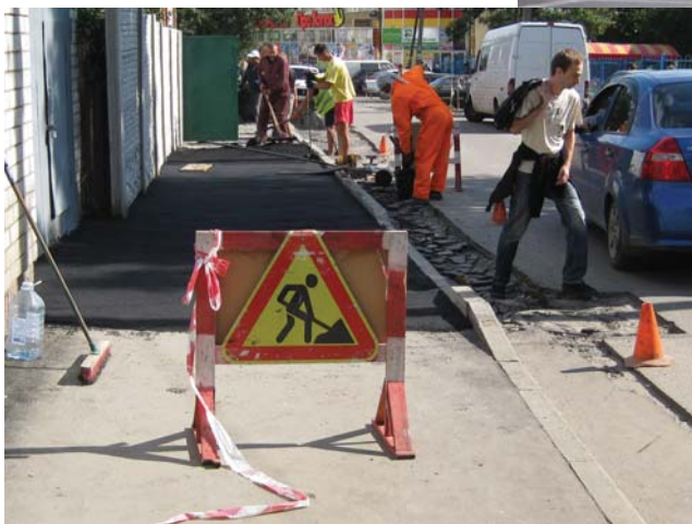
Через ремонт тротуару пішоходи змушені виходити на проїзну частину і наражати себе на небезпеку
