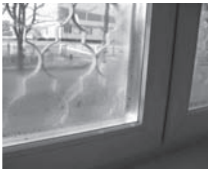
Рис. 6.5.12 Утворення конденсату на поверхні вікна.
