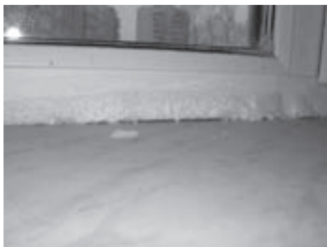
Рис. 6.5.14 Утворення льоду на підвіконні.
