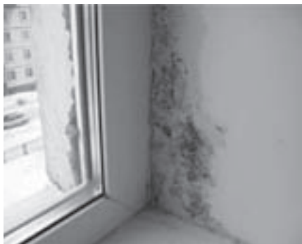
Рис. 6.5.13 Утворення плісняви на віконному відкосі.
