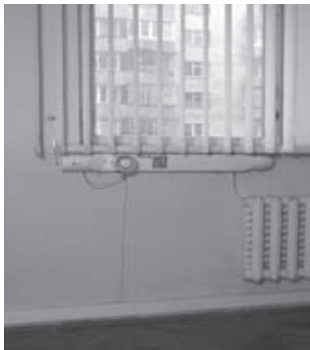
Рис. 6.5.18 Рекуператор встановлений під віконним прорізом.
